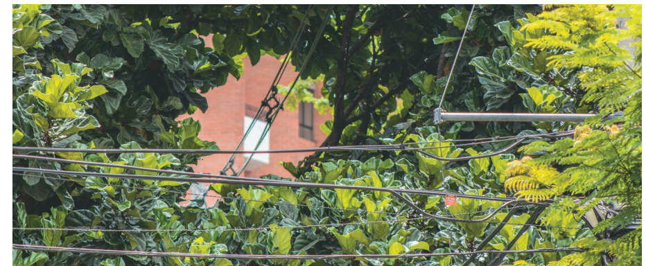
Figura 7. Árboles grandes en contacto con cables aéreos compactos de distribución de energía.
