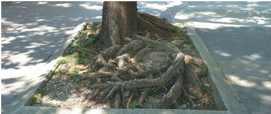
Figura 10. Diseño inadecuado de alcorque por los bordes que impiden el ingreso de agua al suelo.
